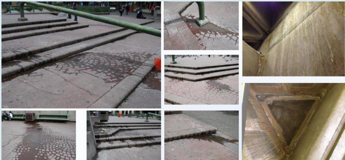
Ilustración 2. Problemas de filtraciones en la Plaza de la Cultura, previo a la intervención
